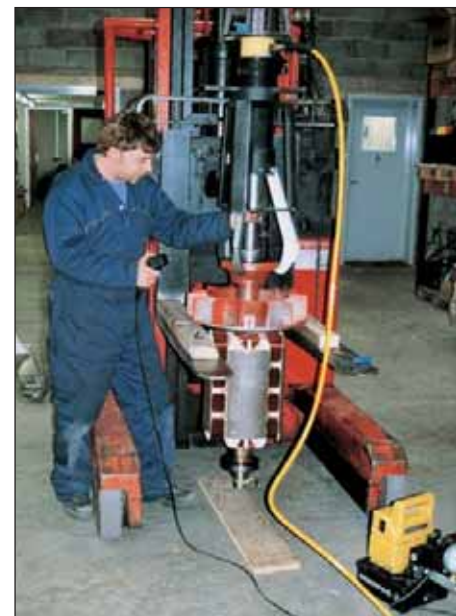
▲ Se utiliza un Extractor Hidráulico EPHR-116 para trasladar un motor eléctrico. El extractor se posiciona utilizando una placa de elevación.
